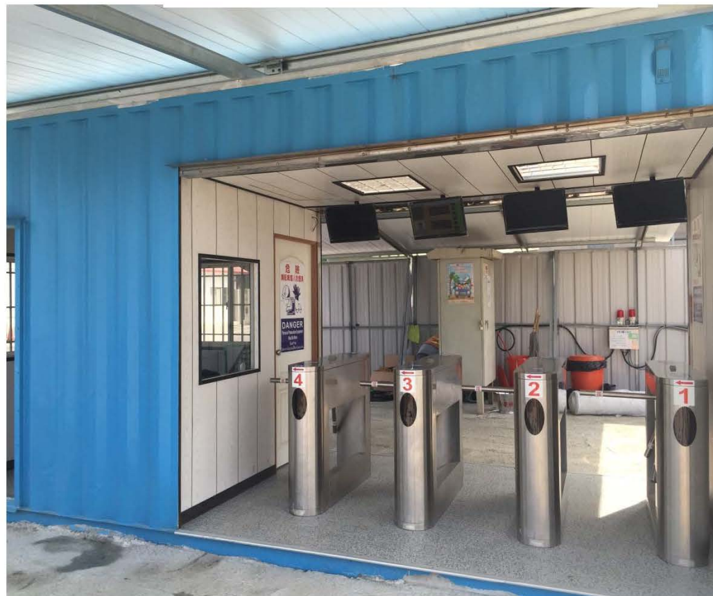
人員管制門禁設備
